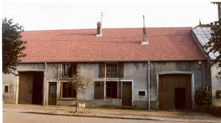
Afb. 24.2-1 De voorgevel van het huis. Er is duidelijk te zien waar de goot gelekt heeft.
