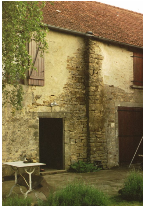
Afb. 24.2-10 Amateuristisch verbonden dakgoten
