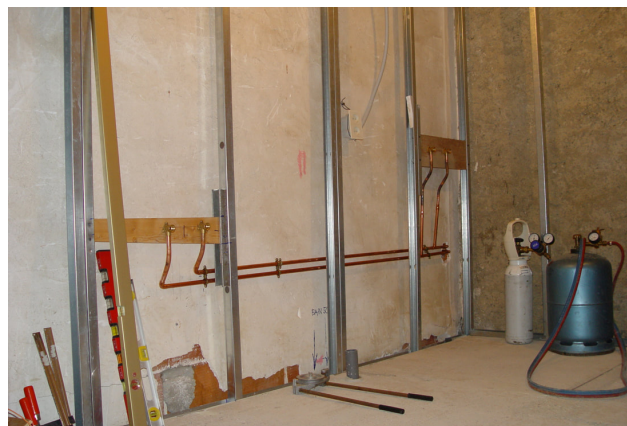
Afb.24.1-8 Koperen waterleidingen achter de metalen staanders
