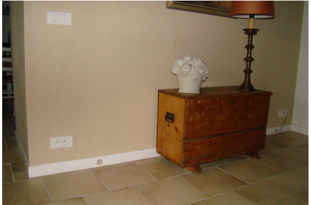
afb. 17.5 - 8 beluchtingsrozetten in de plint, hier van wit plastic
