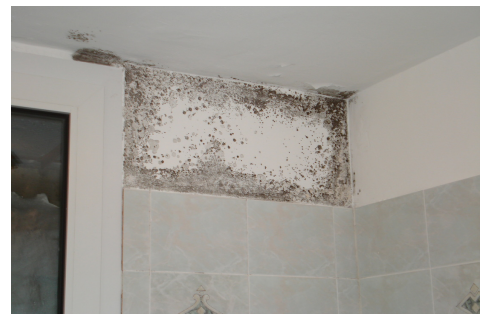
afb. 17.4 - 3 Schimmel in een badkamer. Condensvorming aan de niet geïsoleerde buitenmuur
