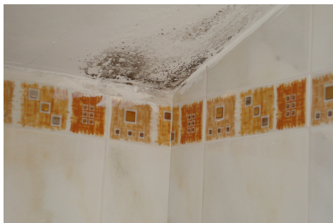
afb. 17.4 - 2 Schimmel in een badkamer. Condensvorming aan het ontoereikend geïsoleerde dak
