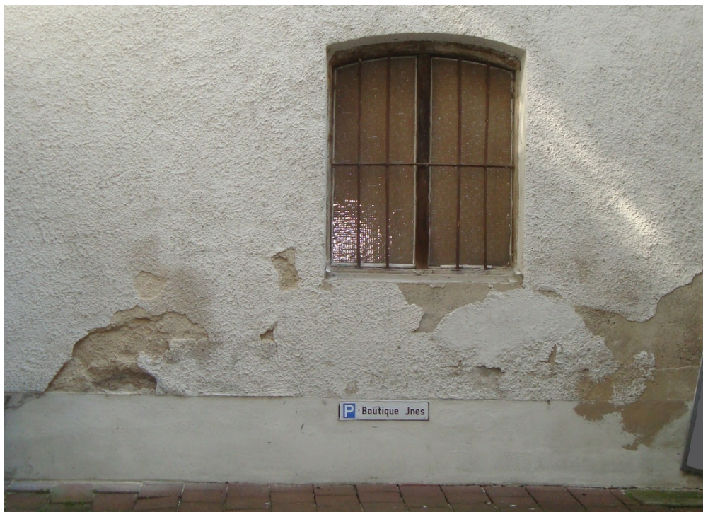
afb. 17.2 - 3 Nog een gecementeerde plint
