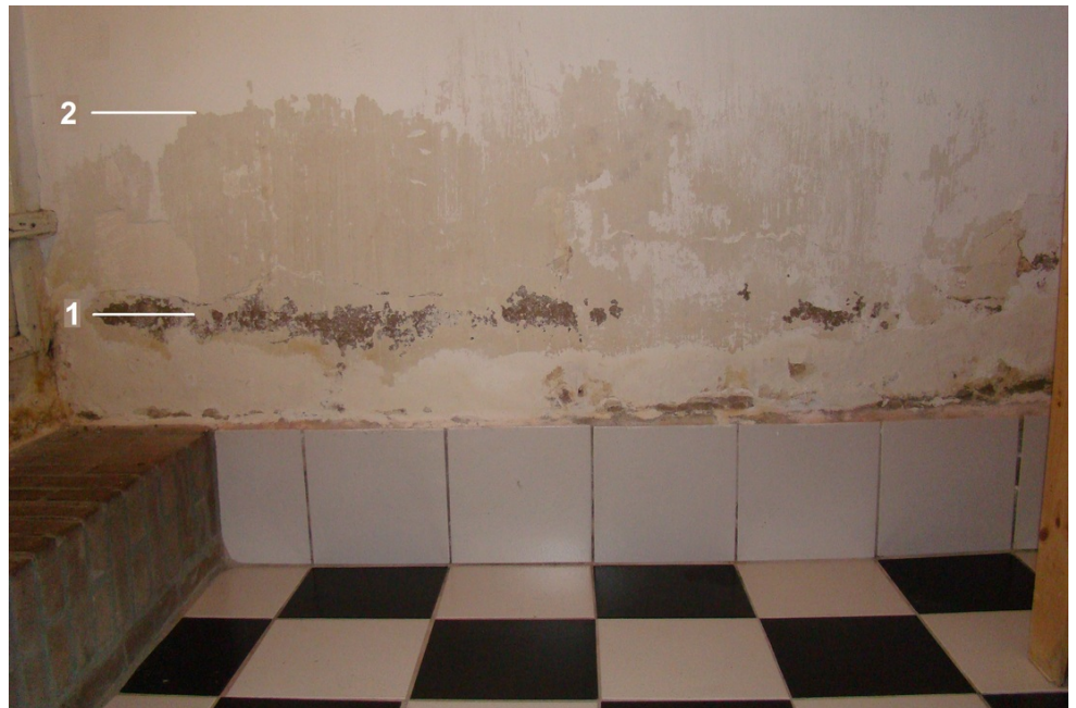
afb. 17.2 - 1 Vloer in vroegere schuur : (1) oorspronkelijke vochtgrens (2) vochtgrens na betegelen
