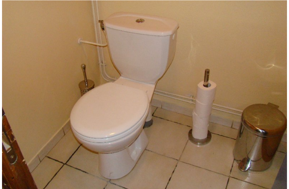
afb. 12.1.3 - 12 Leidingen voor de belendende badkamer door WC ruimte gelegd
