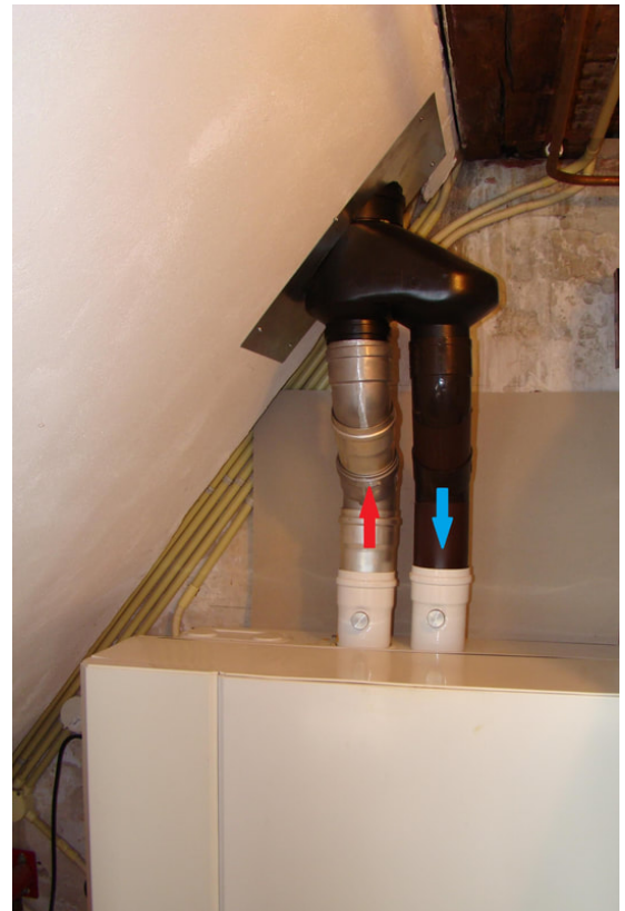
afb.12.1.3 - 5c Ventouse van een HR-ketel onder het dak, binnenaanzicht. Links: rookgasafvoer, rechts luchttoevoer
