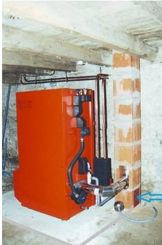
afb. 12.1.3 - 3 Ketel met tubage inox in een schoorsteen van boisseaux. Pijl = servicedeurtje
