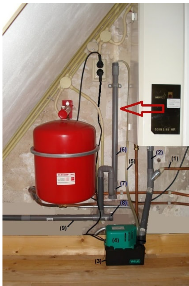
afb. 10.2.1 - 11 Opvoerunit, hier bij een HR-ketel. Pijl: Hoogte van de badkuip, die achter de muur ligt en op dezelfde afvoerleiding aangesloten is.
