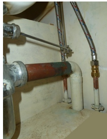
afb. 10.1.7 - 2 Rechter wastafel: Dit is een grensgeval, misschien net nog goed, maar misschien was ook hier een hogere ligging van de aansluitingen op zijn plaats geweest.
