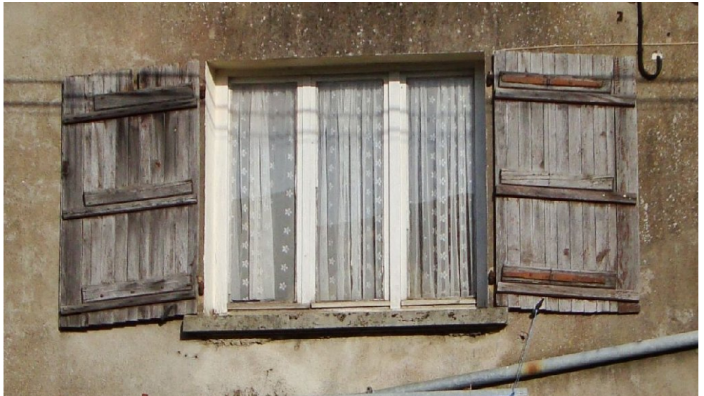
Uitgezakt omdat de 'écharpes' ontbreken. De boven de 'bandes' opgespijkerde bredere latten hebben ook niet geholpen!
