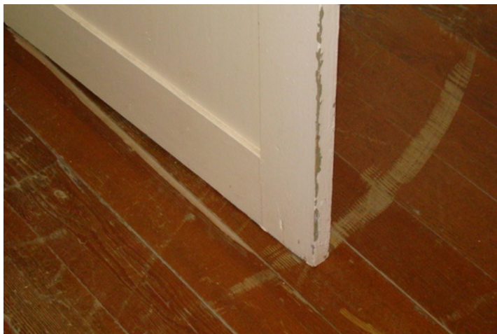
Afb.09.1.1 - 7 Deur raakt vloerplanken
