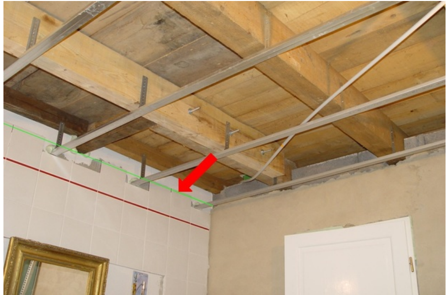
afb.08.3 - 9 Rails onder een oude gerepareerde balklaag. Let op het groene metselkoord links.
