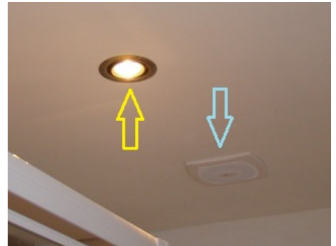
afb.08.3.2 - 19 Inbouwspot en ingebouwde ventilator
