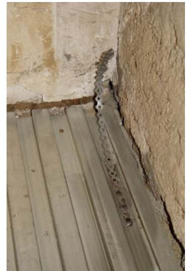
afb. 08.2.3 - 7 Aardingsstrip op een Lewisplaat geschroefd en gesoldeerd
