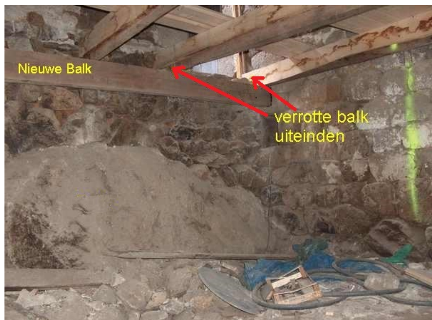
afb. 08.1.5 - 11 Verrotte balkkoppen ondersteund door een nieuwe balk
