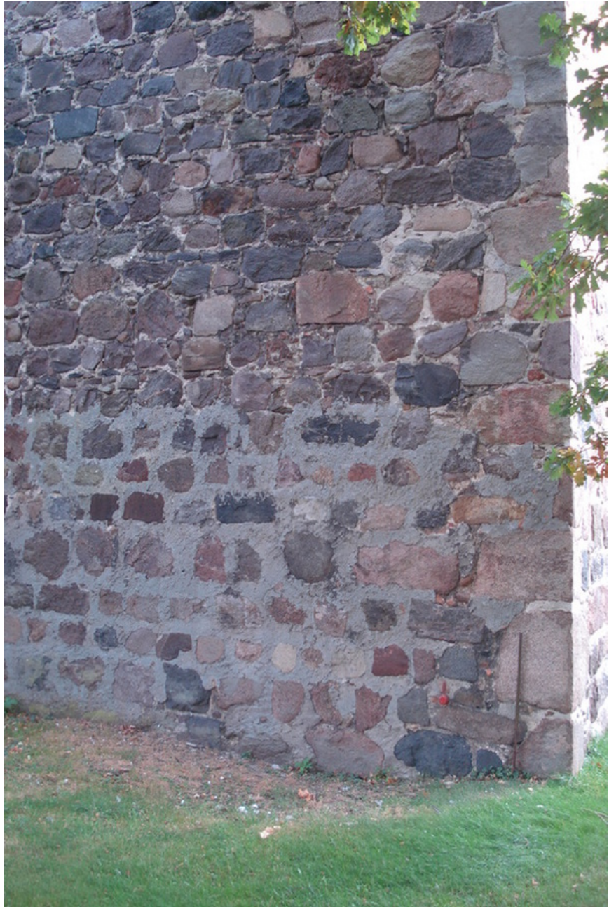
afb.07.2 - 24 Zo dus niet, met cement voegen, en dan nog op een monumentenpand! Brrrr!
