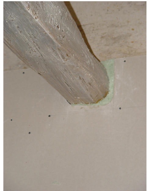
afb. 07.1.1 - 26 Het overtollige PUR-schuim is hier weggesneden -&gt; excessive foam cut away
