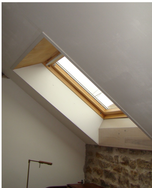
afb. 06.5.5 - 1 Bovenkant niet helemaal zoals het moet.
