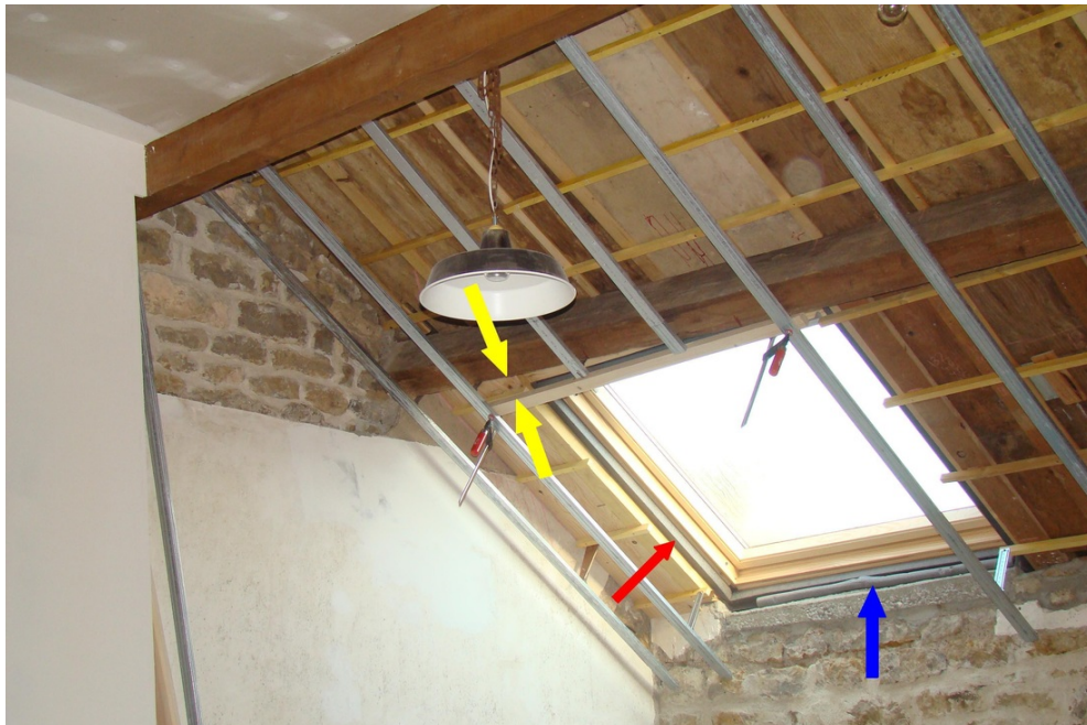
afb. 06.5.3 - 13 Alles scheef (gele pijlen). Velux BDx isolatieframe (rode pijl). Opvullende Isolatie (blauwe pijl).
